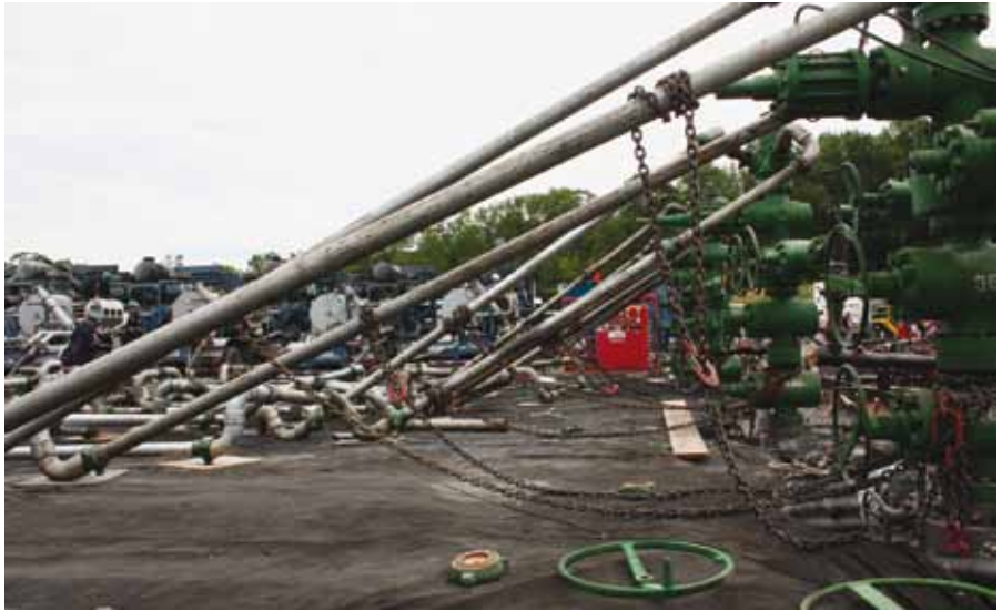
Abb. 4: Förderanlage in den USA, Foto: Gelsenwasser
